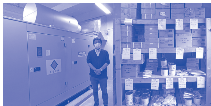
巨大な発電機
